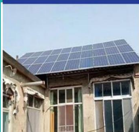
家庭离网太阳能供电
