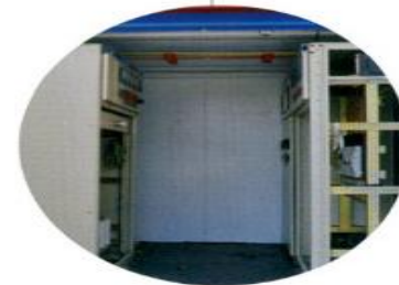
变电站低压室
