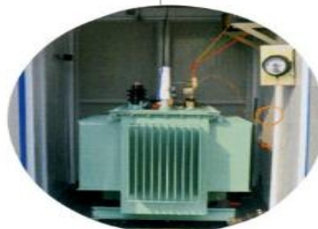
变电站变压器室
