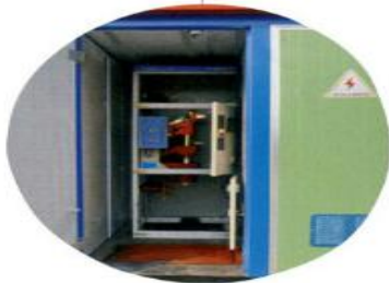
变电站高压室
